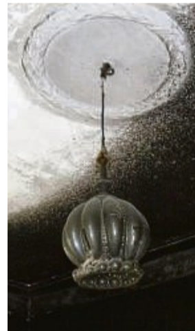
Im Laufe der Jahre schwarz verrußt: Wand, Decke und Stuck.
